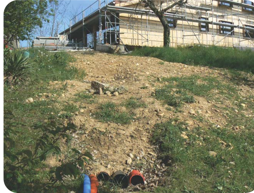
Entrées d'air du puits canadien sur une maison basse énergie (69)
