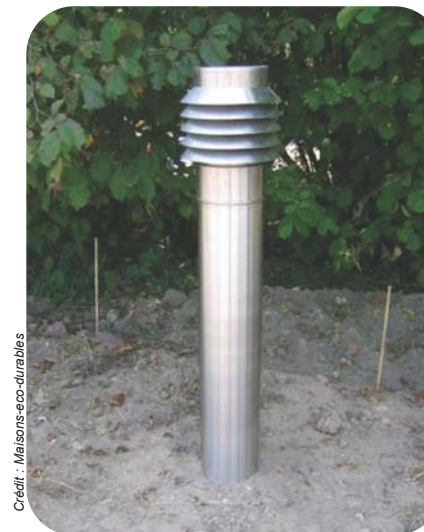
Prise d'air du puits canadien situé à l'extérieur du bâtiment
