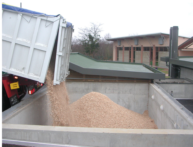
Photo 2 : stockage de la chaufferie de la Tour-de-Salvagny
