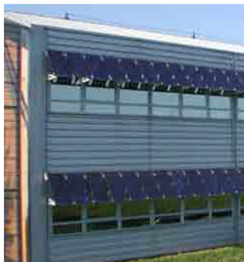
Source : ALE Lyon, Tenesol, la Tour de Salvagny
